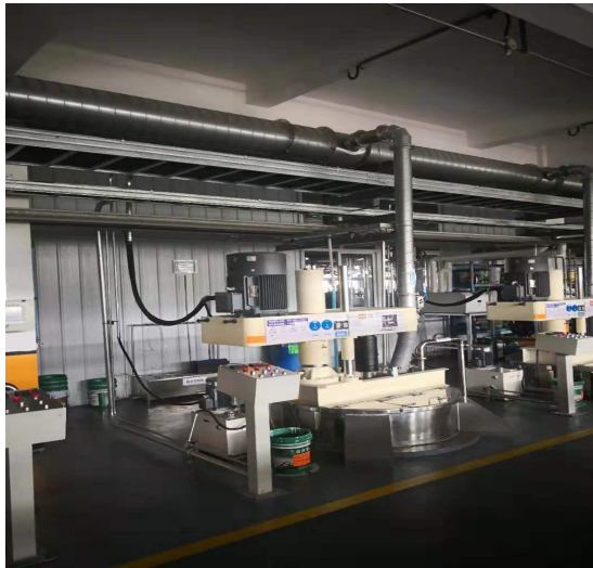
调漆工序管道直连设备
