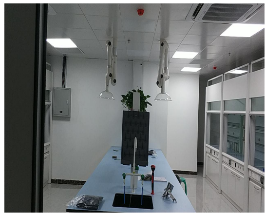
配料、调漆工序集气装置 2
