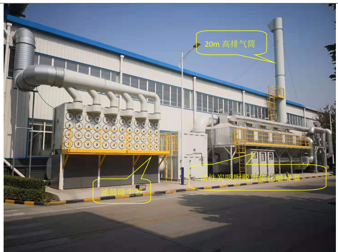
2#滤筒除尘器+活性炭吸附脱附催化燃烧器
