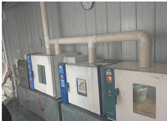
检验间烘干工序管道直连设备
