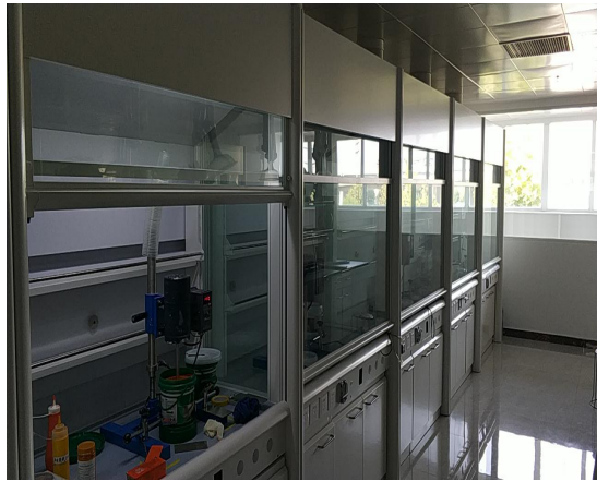
配料、调漆工序集气装置 1
