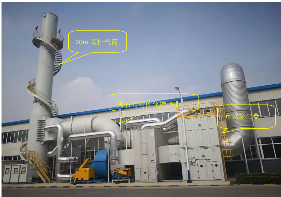
布袋除尘器+沸石转轮催化燃烧器处理设施+20m 排气筒
